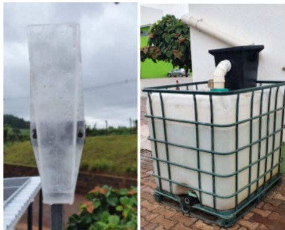
Figura 11 - Instalação de pluviômetro juntamente com a verificação da quantidade de água captada
