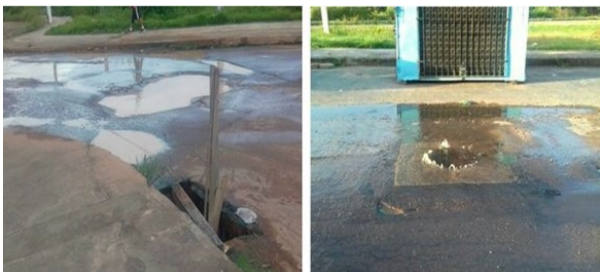
Figura 5 e 6: Vazamento e transbordamento dos PV's
