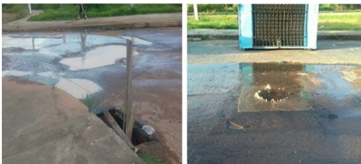
Figura 5 e 6: Vazamento e transbordamento dos PV's
